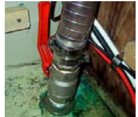
Kulventil och dubbla slangklämmor. Foto: Gert Swenson.
