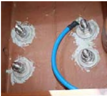
Kölbultar med låsmuttrar. Notera jordkabeln. Foto Sam Behrman.
