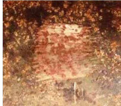
Avzinkad, korroderad bordgenomföring
